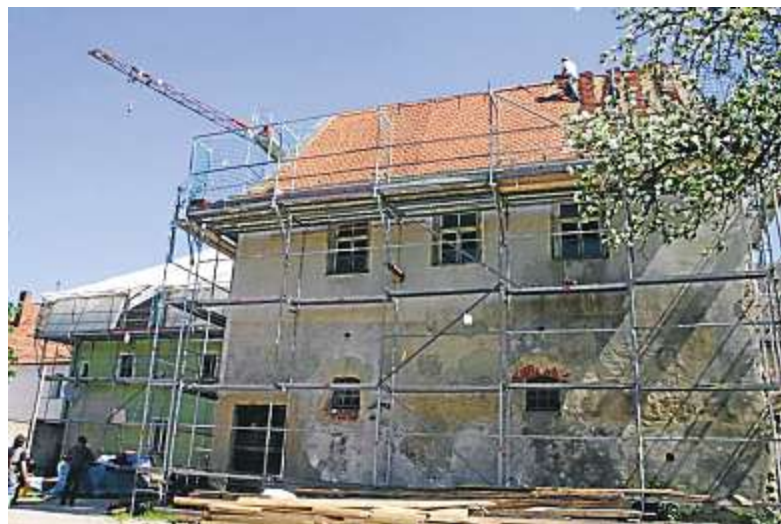
Lagebesprechung zur Sanierung: oben von links. Dipl.-Ing. Anton Landgraf, Bauherr Dr. Konrad Lautenschlager, Architektin Petra Hofmann und Zimmerermeister Hans Schlegl. Groß ist der Sanierungsbedarf, marode und vermoderte Balken mussten ersetzt werden (Mitte). Mit rund 35 000 roten Ziegeln wurde das Dach des denkmalgeschützten ehemaligen Klostrichterhauses neu eingedeckt (unten). Fotos: Bab
